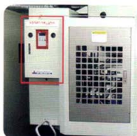
〈소화기 내장 Control 박스〉
