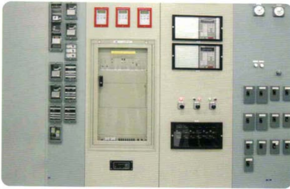
〈154KV 배전반 설치 : 수자원공사 OO본부〉
